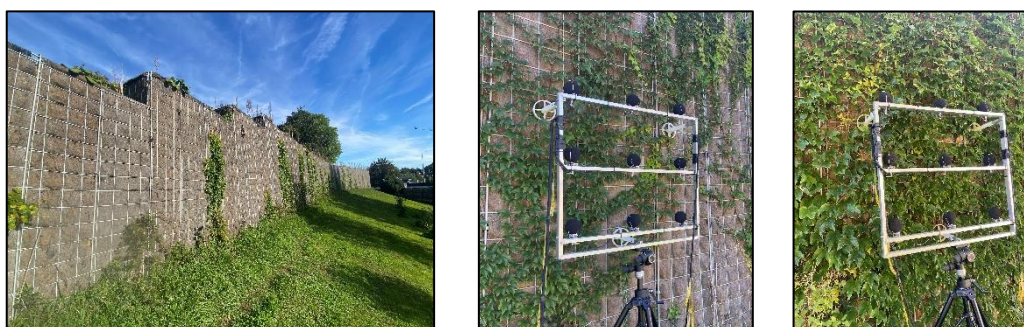
Abbildung 21: Steilwall an der Schnellstraße A7 (links) und durchgeführte Schallreflexionsmessung bei partiellem (mittig) und durchgehendem Bewuchs (rechts) an exemplarischen Wallabschnitten.
