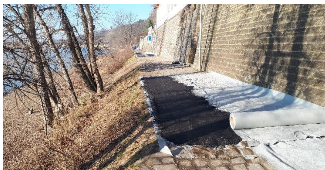
Abbildung 6 Auftrag einer Asphaltdecke auf einem Pflasterdecke in Dresden (Foto: Straßen- und Tiefbauamt Dresden)
