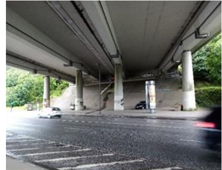
ABB 1. Stahlbetonbrücken verschlechtern sich und sind instandhaltungsbedürftig. Eine genaue Einschätzung der Restnutzungsdauer ist wichtig, um die begrenzten Instandhaltungsressourcen zu verteilen.
