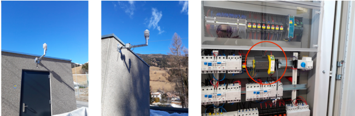
Abbildung 40 Station in Abfaltersbach (links), Weitlanbrunn (Mitte) und der Anschluss im Elektroverteiler (rechts)
