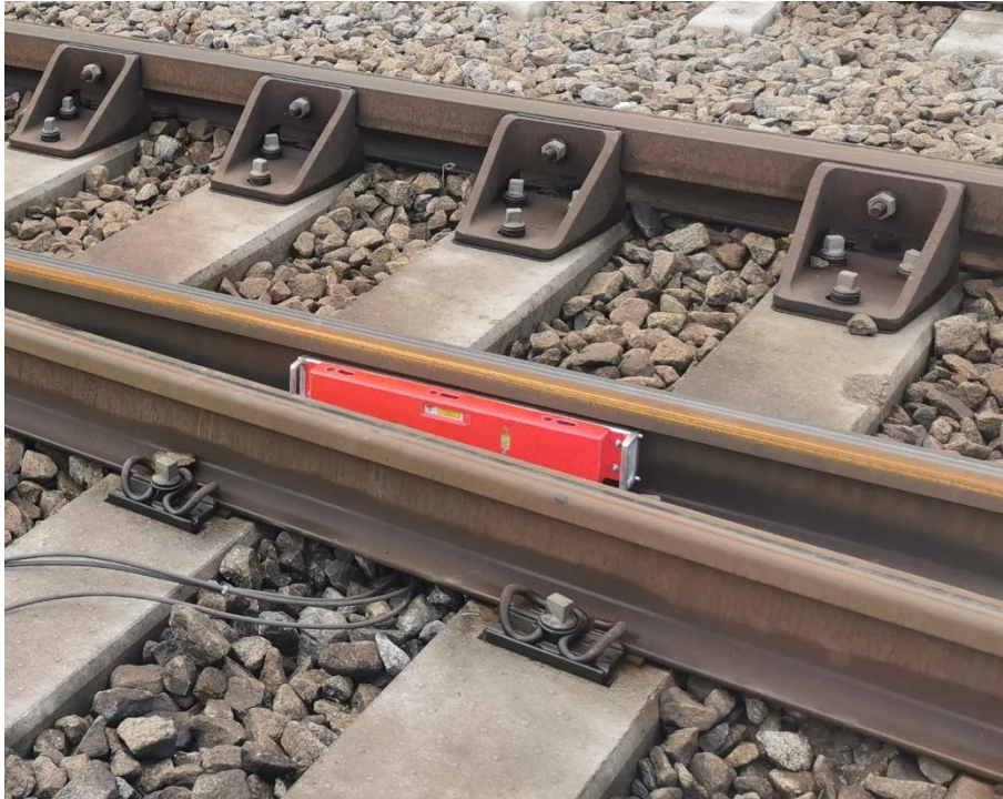
Abbildung 63: Positionierung der Messleiste und Kabeldurchführung unterhalb der Schiene
