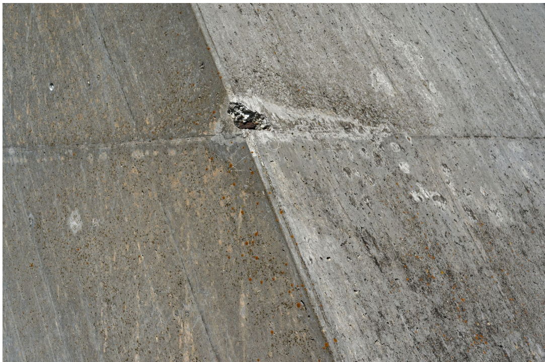
Abbildung 31: Aufnahme einer schadhaften Betonoberfläche - Abplatzung mit freiliegender korrodierter Bewehrung: Aufnahme nicht senkrecht zur Oberfläche, sondern über Eck; Aufnahme ohne Umgebungskontext
