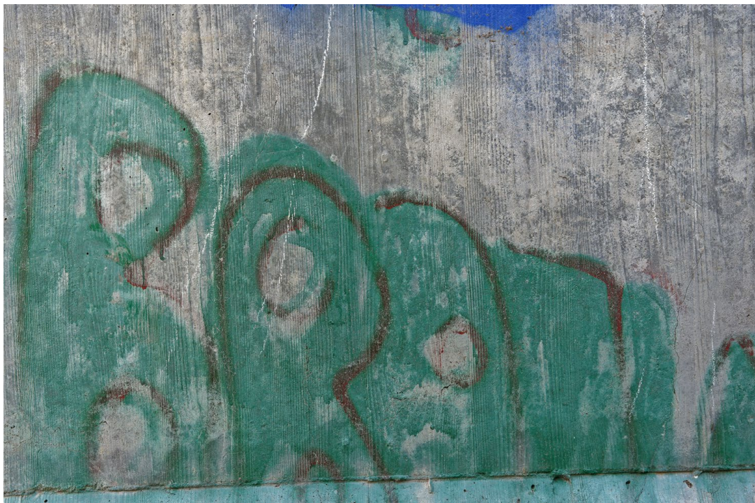
Abbildung 35: Aufnahme einer schadhaften Betonoberfläche - Riss (rechts) und Graffiti: Aufnahme nicht senkrecht zur Oberfläche; Aufnahme ohne Umgebungskontext
