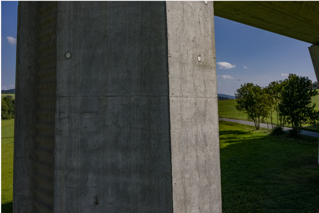
Abbildung 34: Aufnahme einer schadhaften Betonoberfläche - mehrere Risse: Aufnahme nicht senkrecht zur vorderen Oberfläche, sondern über Eck; Aufnahme mit Umgebungskontext und unterschiedlichen Belichtungen der einzelnen Bauwerksflächen
