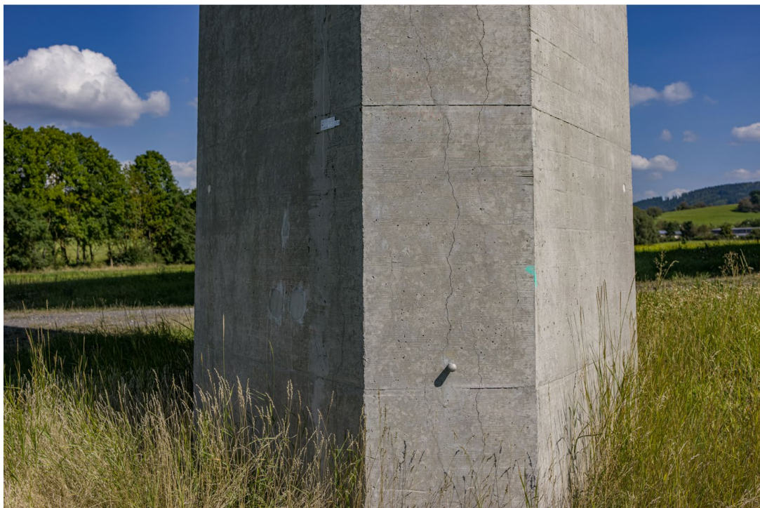
Abbildung 33: Aufnahme einer schadhaften Betonoberfläche - mehrere Risse: Aufnahme senkrecht zur vorderen Oberfläche; Aufnahme mit Umgebungskontext
