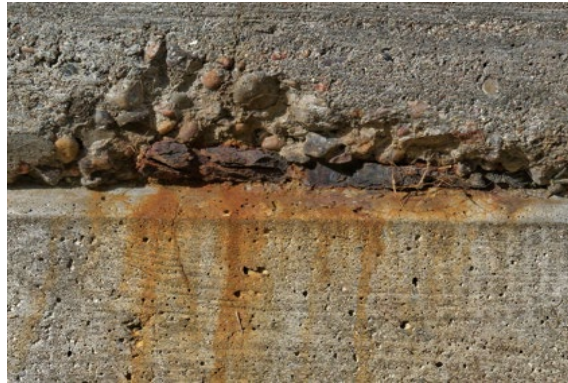
Abbildung 9: Freiliegende Bewehrung mit Rostfahne an einer Betonoberfläche (ASTRA)
