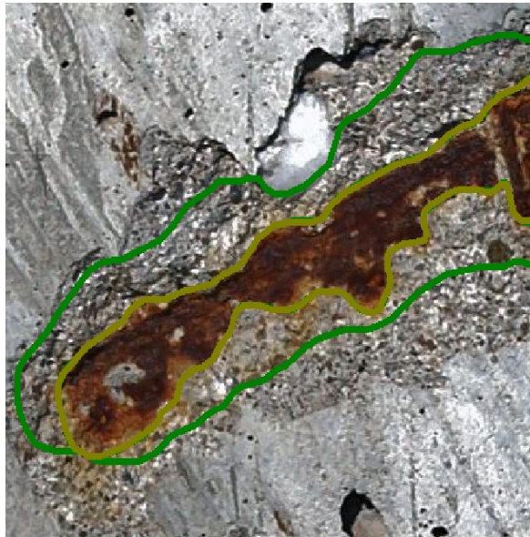
Abbildung 49: Umrandung der einzelnen Defekt Instanzen in der Erkennung. Die Farbe der Umrandung gibt die erkannte Klasse wieder: Grün für Abplatzung und gelb für freiliegende Bewehrung bzw. Rost
