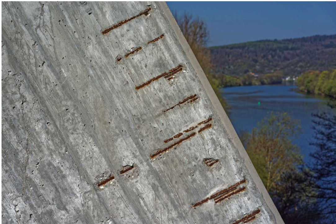
Abbildung 30: Aufnahme einer geschädigten Betonoberfläche - Abplatzungen mit freiliegender korrodierter Bewehrung: Aufnahme senkrecht zur Oberfläche; Aufnahme mit Umgebungskontext
