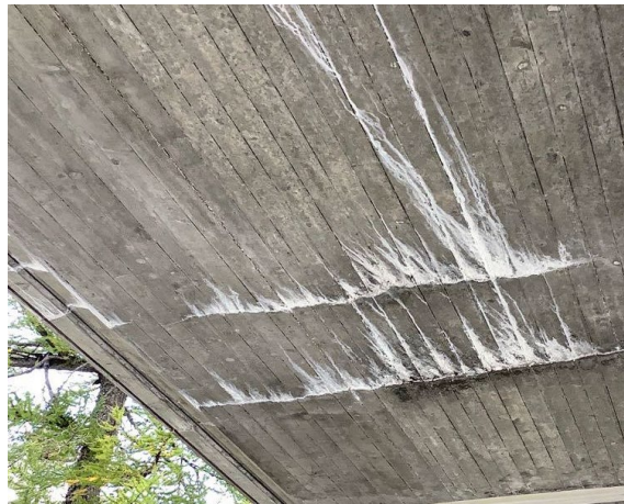
Abbildung 10: Verfärbungen an der Betonoberfläche. Aussinterungen an einer Brückenunterseite (ASTRA)
