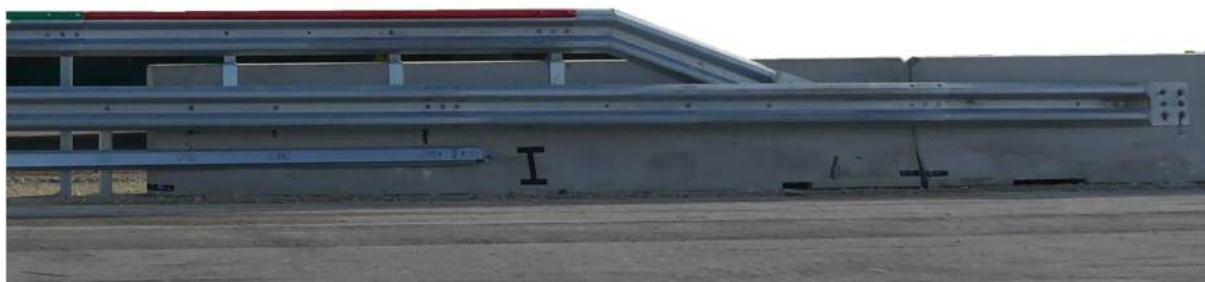
Abbildung 1: Geprüfte ÜK von einem Stahl FRS auf ein Beton Stahl FRS
