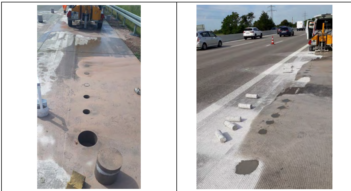
Abbildung 28: Exemplarische Bohrkernentnahme auf der BAB 14 (links) und Exemplarischer Bohrkernverschluss auf der BAB 5 RF Basel (rechts).
