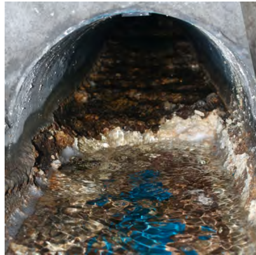
(b) Ulmendrainage im Siebergutunnel
