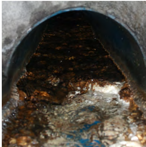
(a) Ulmendrainage im Siebergutunnel
