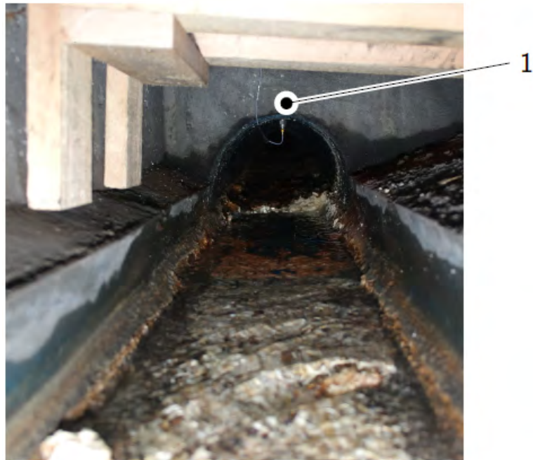
Abbildung 3.33: Der zweite Sensor des Messsystems (1) wurde an der Oberseite des Drainagerohres befestigt.
