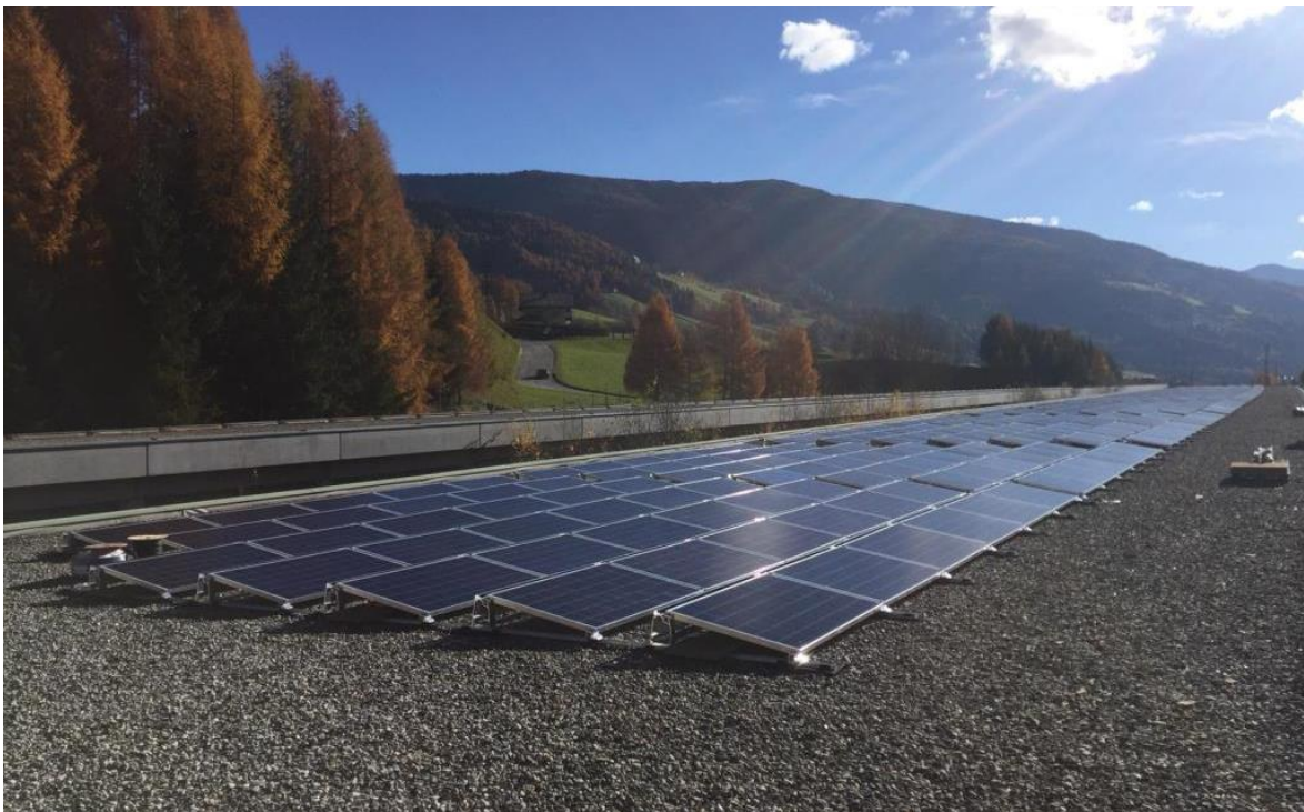
Abbildung 2: Standard-PV-Anlage auf dem Dach des Südportals des Katschbergtunnels in Österreich. Bildquelle: ASFINAG
