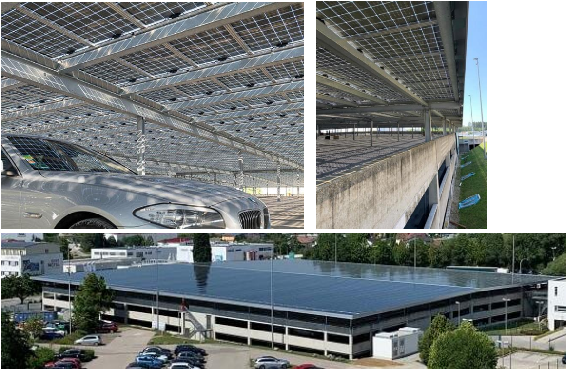
Abbildung 5: Photovoltaikanlage am Parkhausdach mit Glas-Glas PV Modulen. 4
