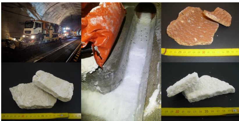
ABB 1. Collage unterschiedlicher Versinterungen in Drainagerohren [1]
