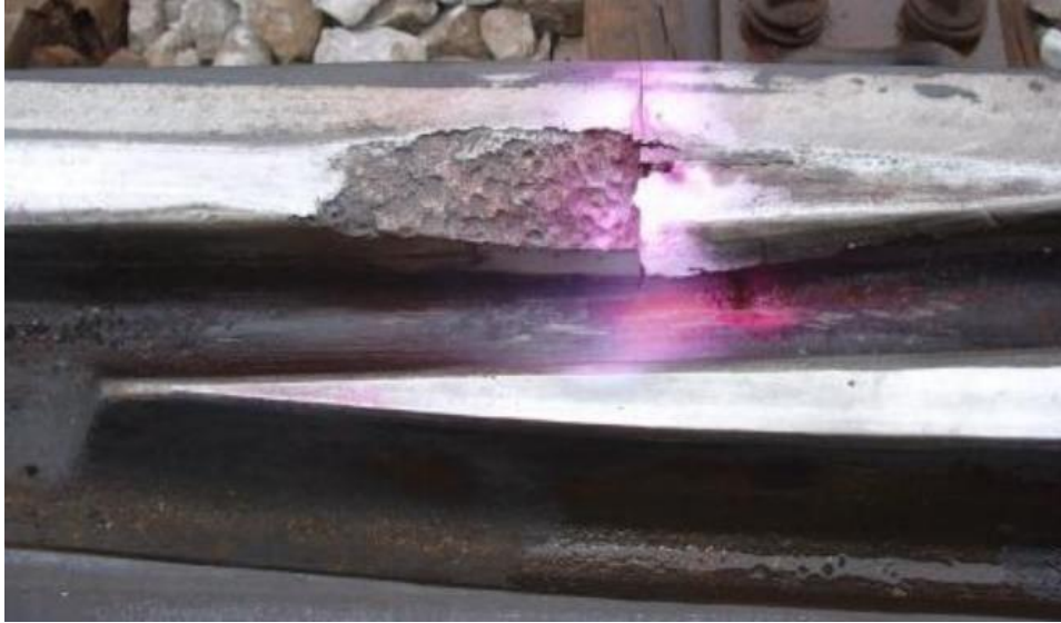
Abb. 4: Ausbruch an der Weiche [4]
