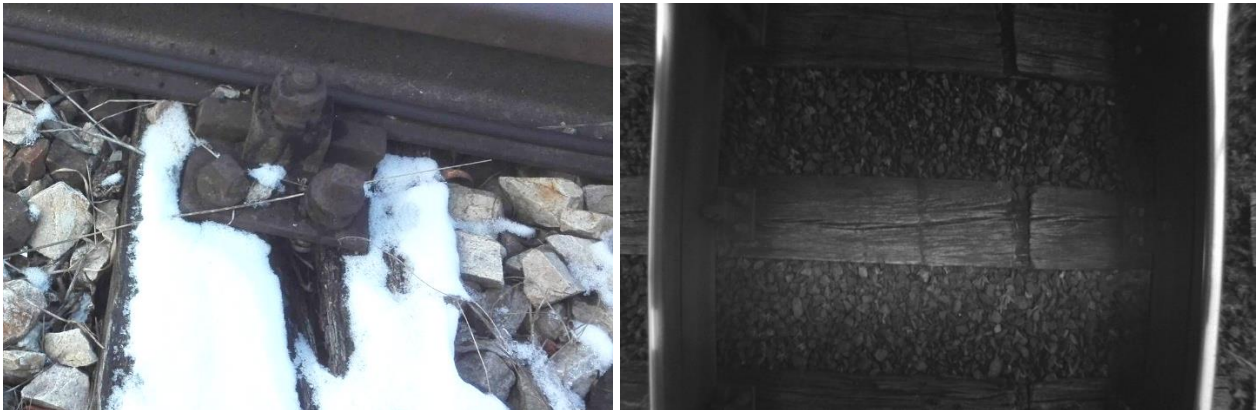
Abb. 17: Lockere Schraube in brüchiger Holzschwelle (links) gebrochene Schwellen (rechts) [3]
