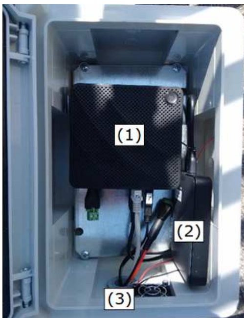
Abbildung 8: Das Gehäuse zum Schutz der Messausrüstung enthält PC (1), Festplatte (2) und Lüfter (3)
