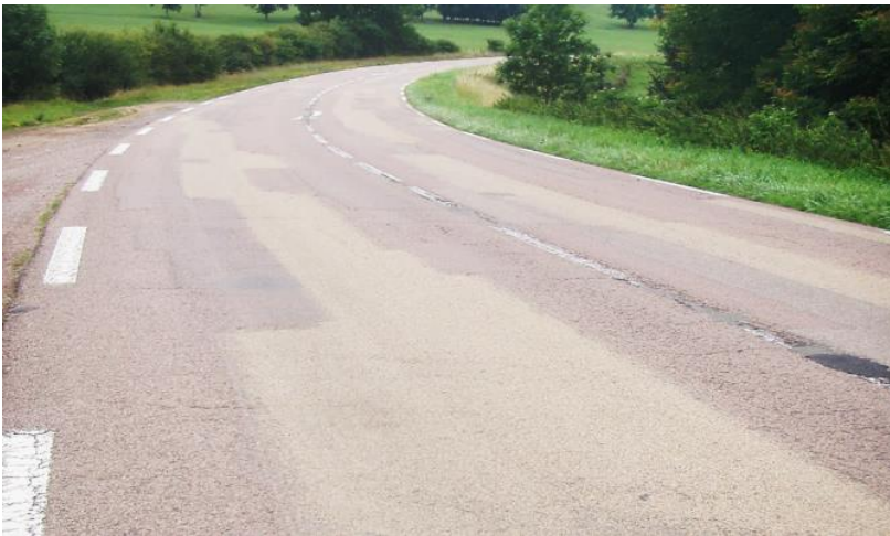
ABB 2. Asphalt Schäden durch ungeeignetes Gestein.
